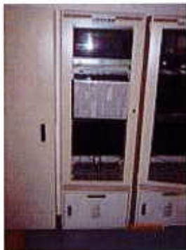
1. 火警自動警報設備
