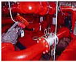
3. 自動撒水設備
