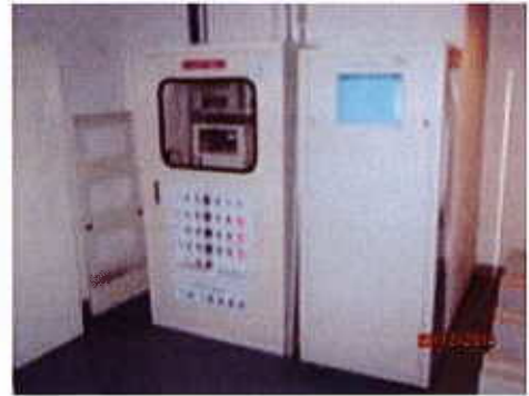
3. 瓦斯漏氣火警自動警報設備
