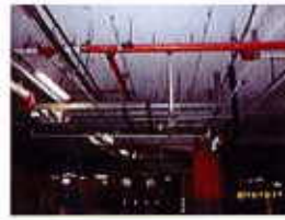
4. 停車場泡沫滅火設備
