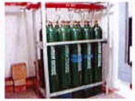
5. 機房二氧化碳滅火設備
