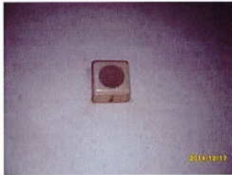
2. 緊急廣播設備
