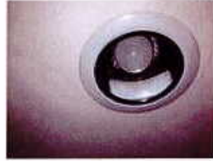
3. 緊急照明設備
